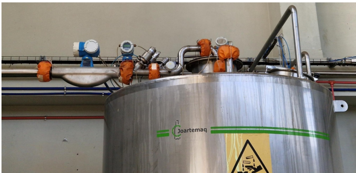
Fotografia 4 - Pormenor dos sistemas de diluição e controle da mistura no reservatório
